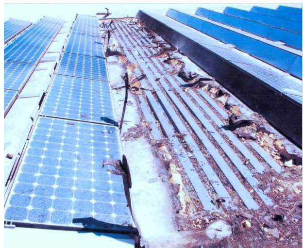
图 3-2 屋顶太阳能光伏电站“自燃”现场
