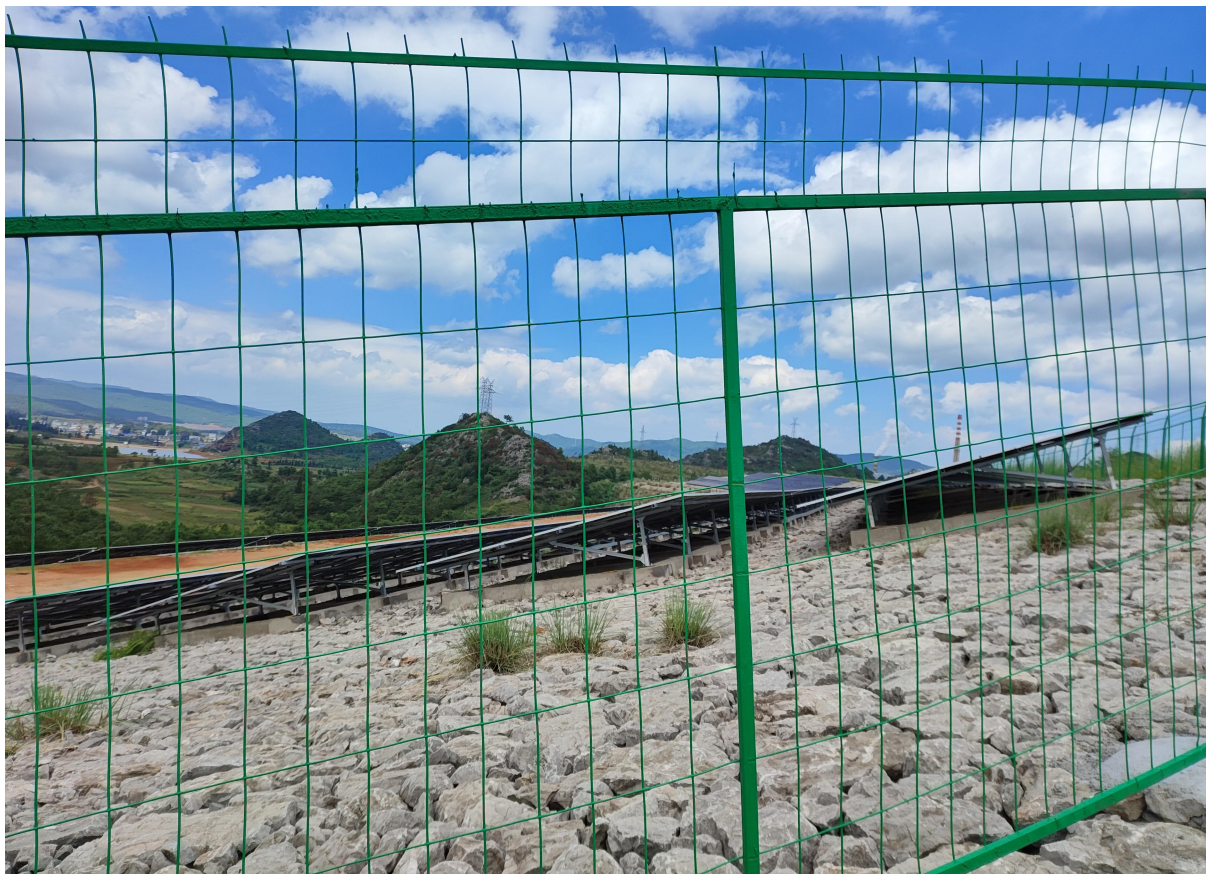
图 5 西南面灰坝坡面 6MWp 分布式光伏区
