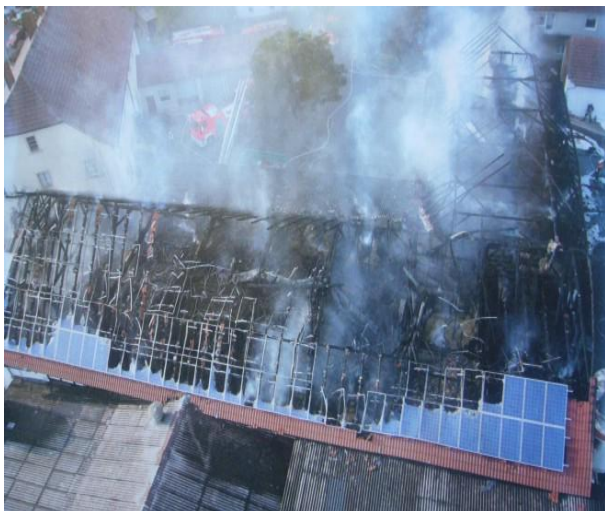
图 3-1 光伏屋顶的太阳能组件“自燃”
