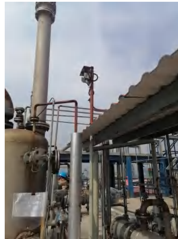
氢气加热器 E201 及氢气探测器
