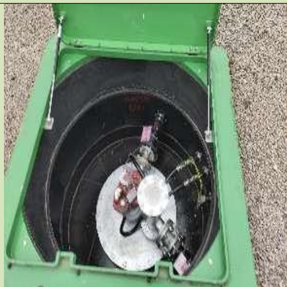
图 7 油罐操作井 B
