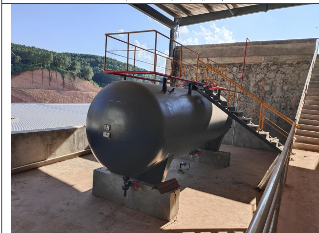
照片 9 氨水储罐
