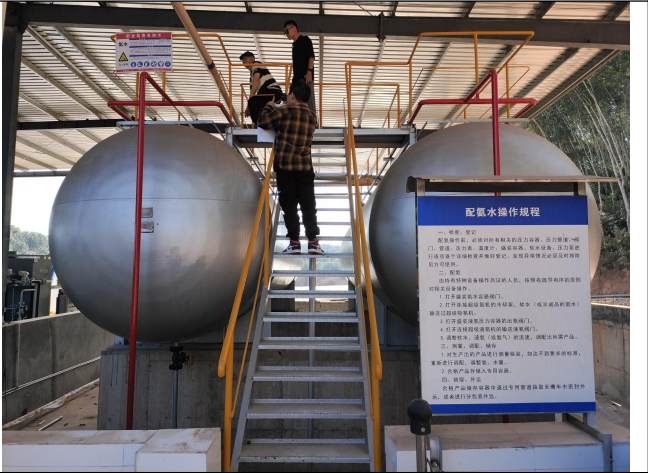
照片 4 氨水储罐
