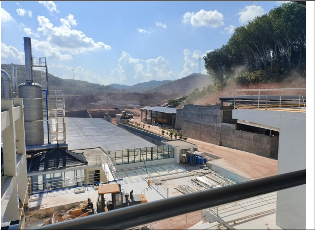
照片 6 胶清车间及厂区道路
