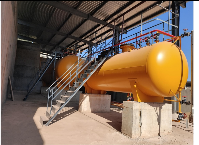
照片 2 液氨储罐
