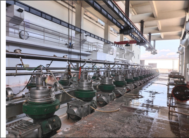
照片 3 浓缩乳胶车间
