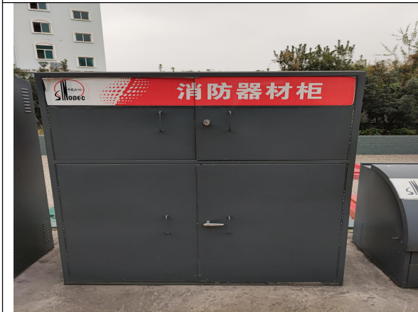
图 4 油罐区消防器材
