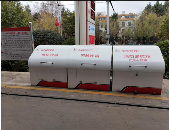
图 3 油罐区消防器材
