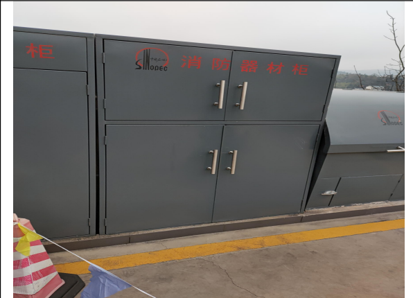
图 12 油罐区消防器材
