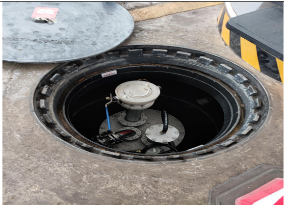
图 9 油罐操作井 B
