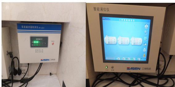
液位仪、双层罐渗漏检测仪
