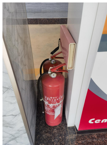
加油现场灭火器和灭火毯
