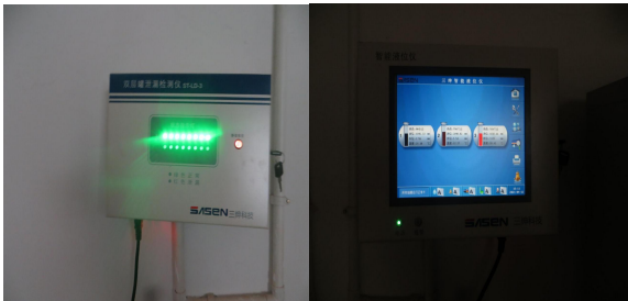
液位仪、双层罐渗漏检测仪
