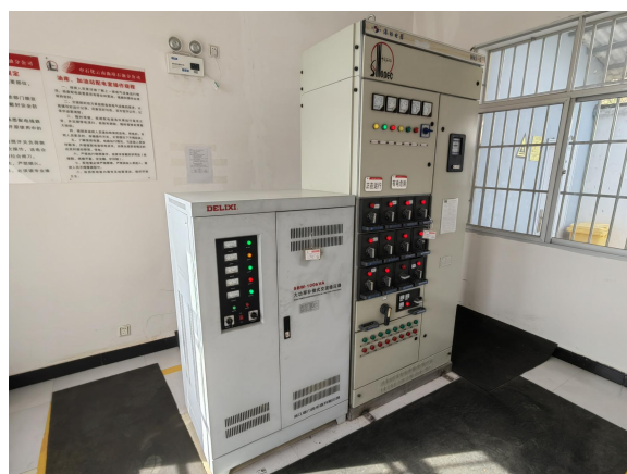
配电柜、电涌保护器及操作规程上墙
