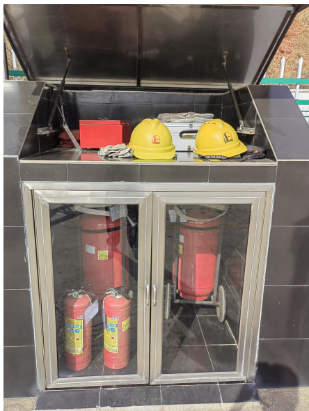
油罐区消防器材
