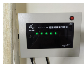
液位仪、双层罐渗漏检测仪
