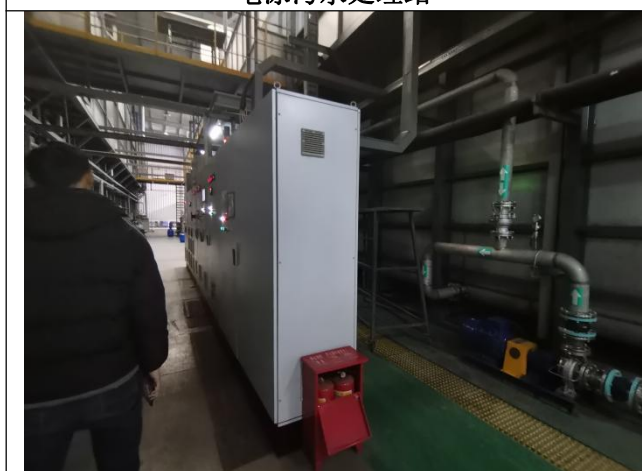
1号电泳、焊接车间配电室
