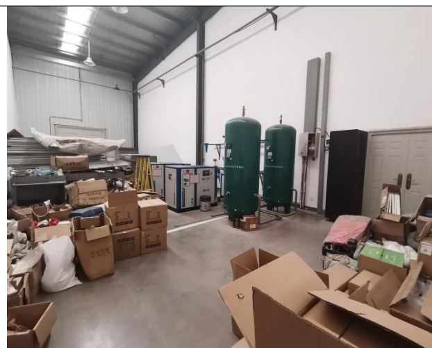
完检车间空压机房
