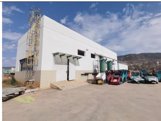
消防泵房、空压气机房
