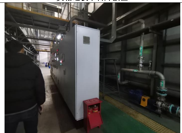
电泳线配电柜
