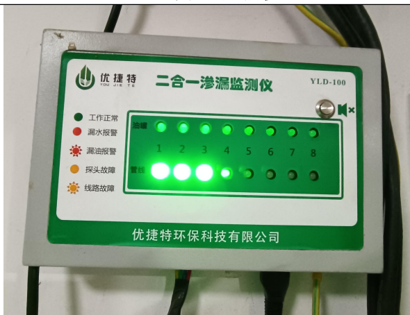
图 14 管道在线监测仪
