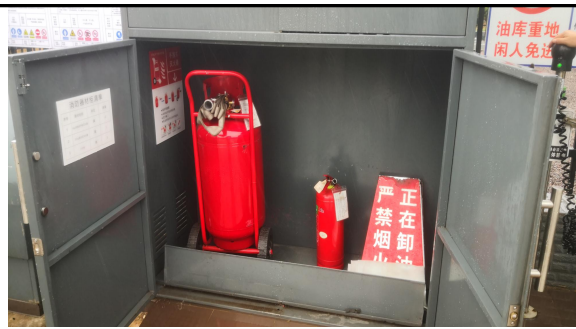
图 10 卸油点消防器材
