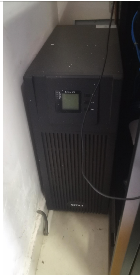
图 8 检测系统 UPS
