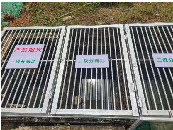
图 15 站房西面绿化地内的隔油池
