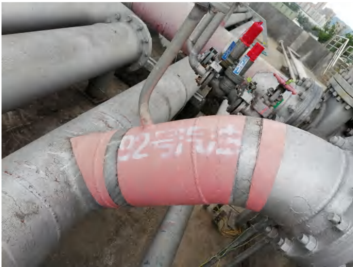
油气回收管路上的电动阀
