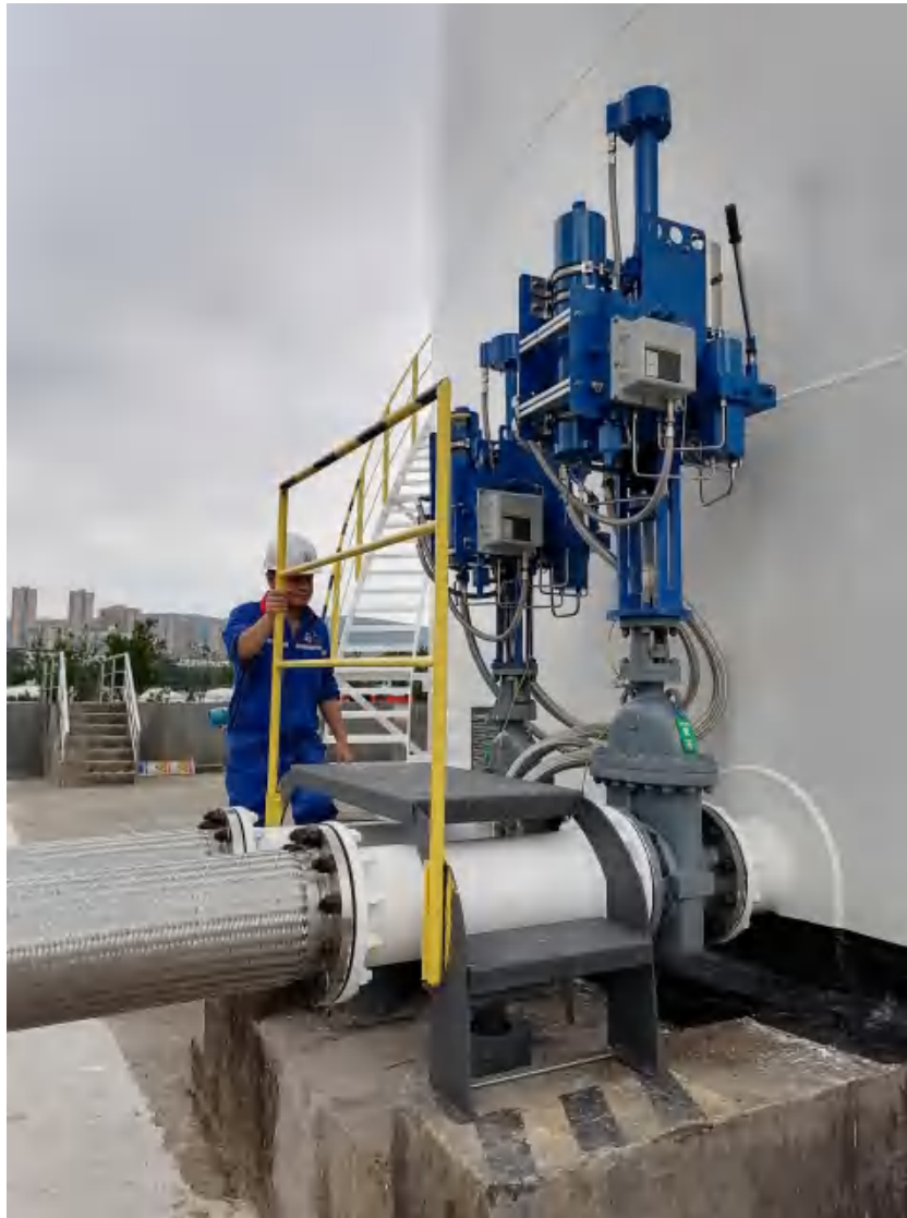
汽油储罐进出口紧急切断阀
