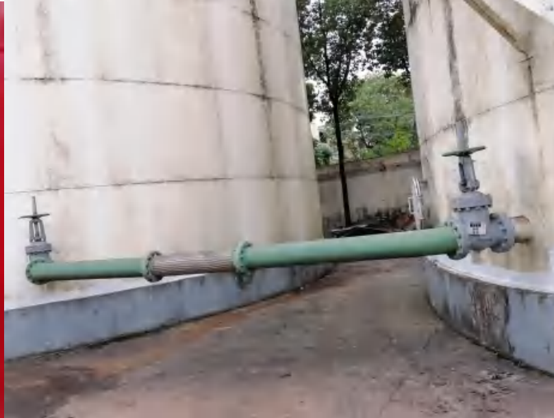
消防水罐连通管
