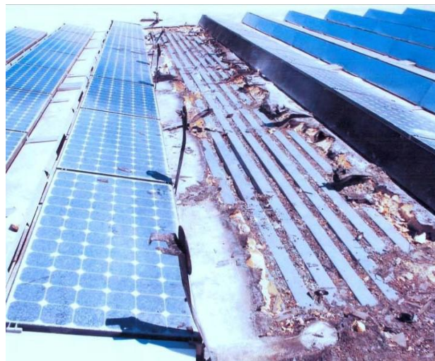
图 3-2 屋顶太阳能光伏电站“自燃”现场
