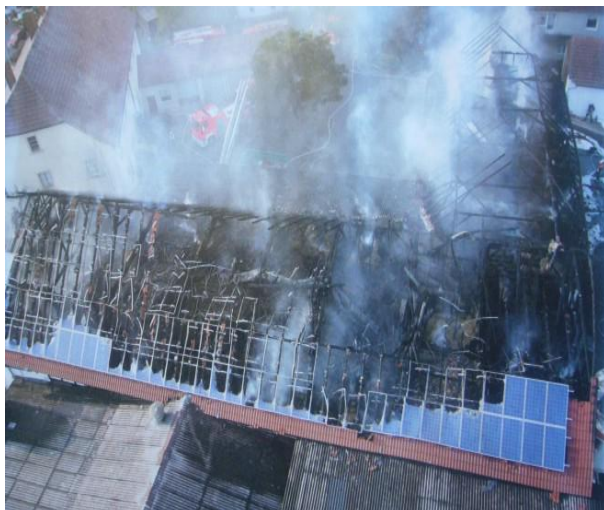
图 3-1 光伏屋顶的太阳能组件“自燃”
