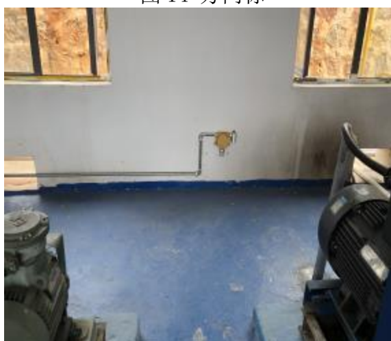
图 16 烃泵间可燃气体探头
