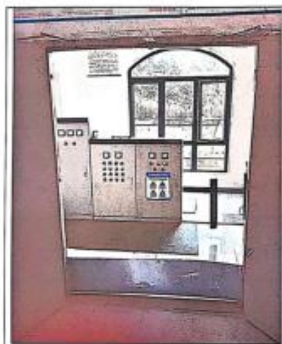
图3 整改前配电间挡鼠版
