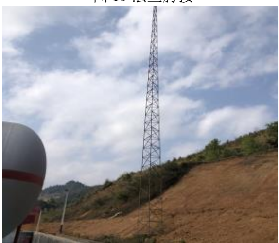
图 21 储罐区避雷针
