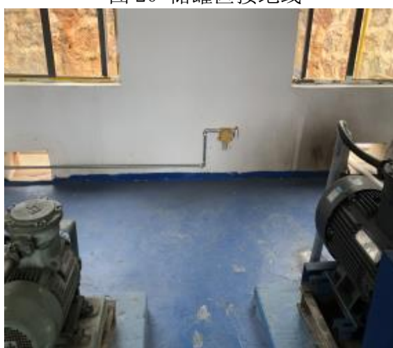
图 22 烃泵间可燃气体检测器
