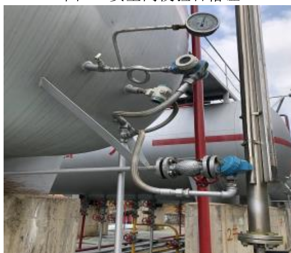
图 12 储罐内压力、温度、液位传感器
