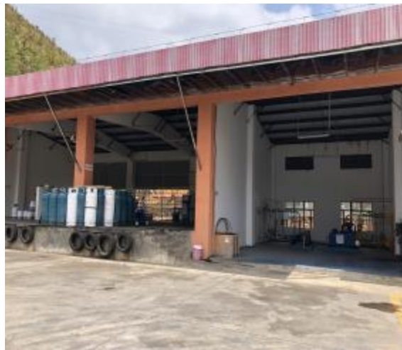
图 8 灌装区及烃泵间
