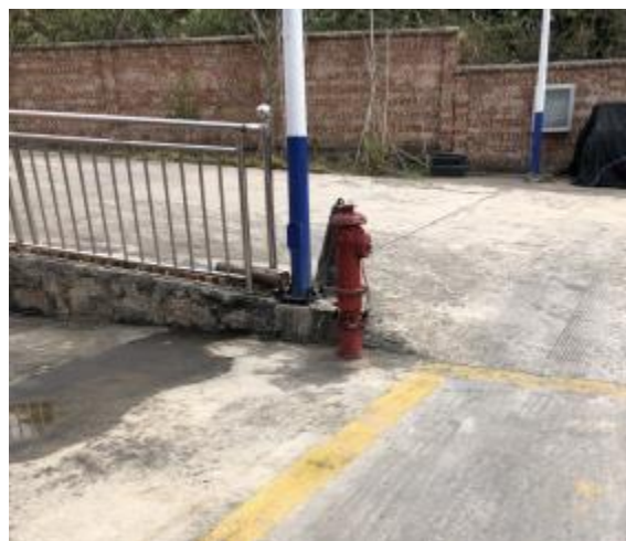
图 26 生产区室外栓
