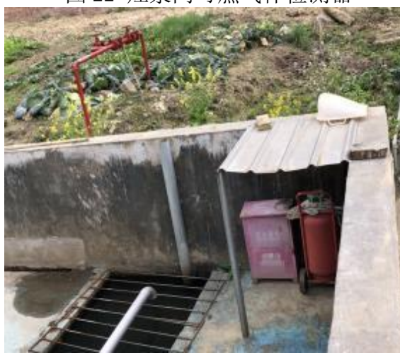
图 24 储罐区消防器材
