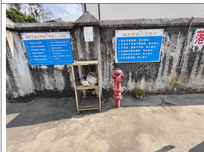
照片 21 室外消火栓
