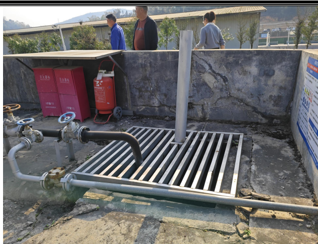
照片 20 罐区手提式、推车式灭火器及排污井
