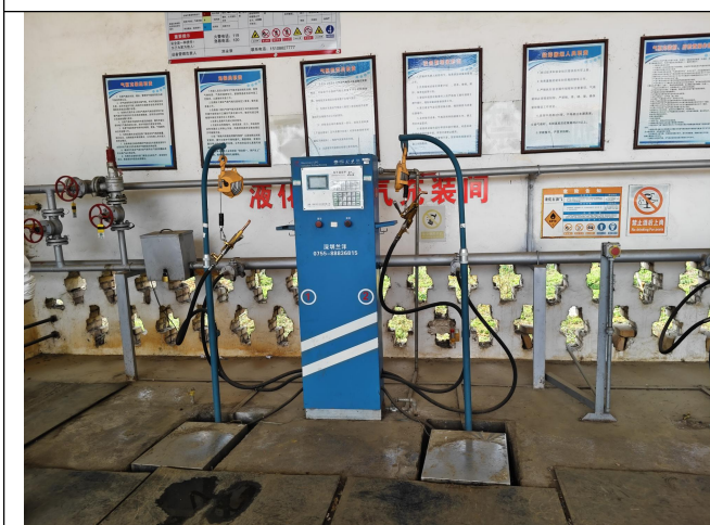
照片 23 液化石油气电子灌装秤
