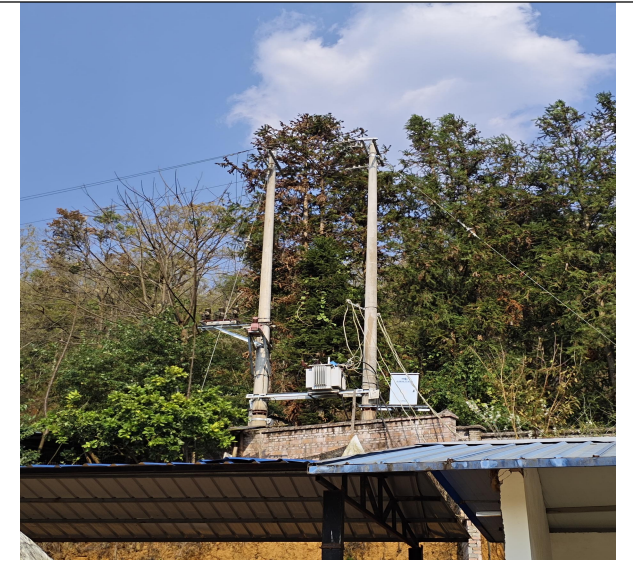
照片 28 电力变压器
