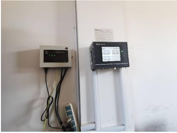
图 18 油罐液位、渗漏检测显示仪
