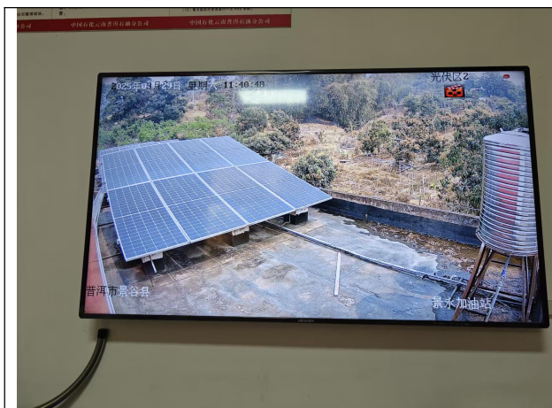
图 29 站房上的光伏组件
