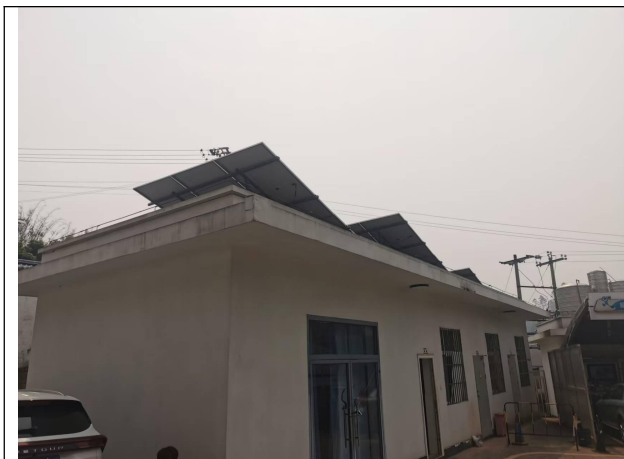
图 23 附房上的光伏组件
