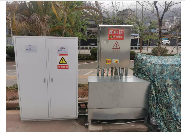
图 24 充电桩旁的配电箱
